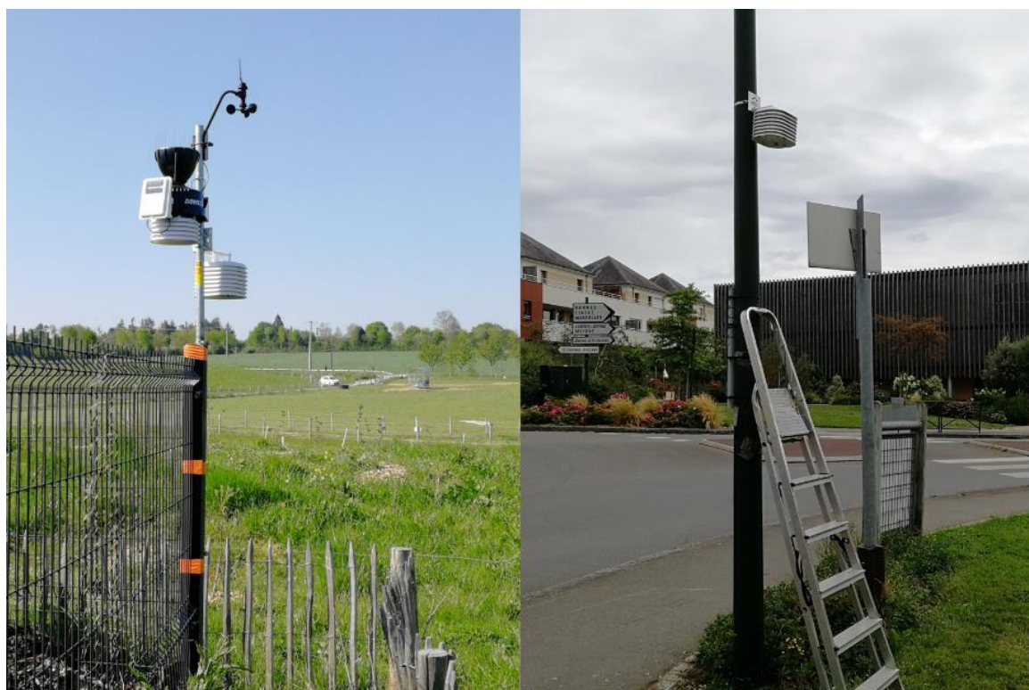
Figura 6 - Algumas fotos mostrando as instalações dos sensores conectados em Rennes.
