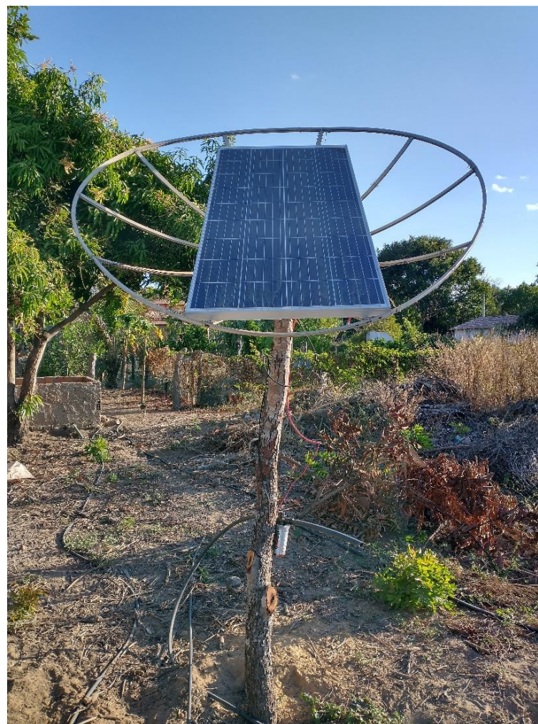
Figura 8 - Placas solares e bomba para irrigação dos quintais produtivos agroecológicos, com instalação adaptada pelas famílias geraizeiras. Rignonato, 2021.
