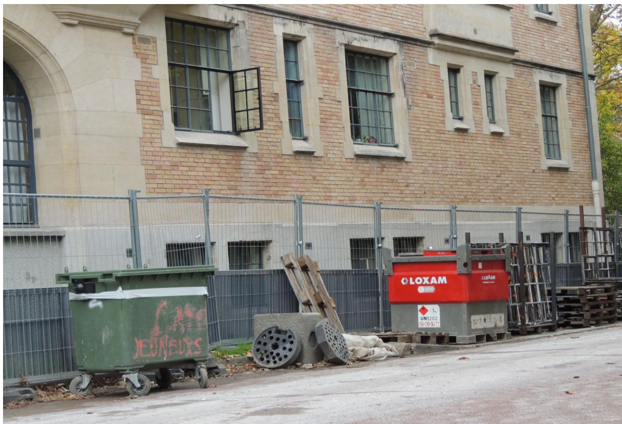
Figura 6 - Fondation. Deutsch De La Meurthe. Bâtiment Pierre et Marie Curie. Canteiro de obras para reparação do Bâtiment Gérard. Cité Universitaire. Paris, outubro de 2021. Foto: Denise Bomtempo.
