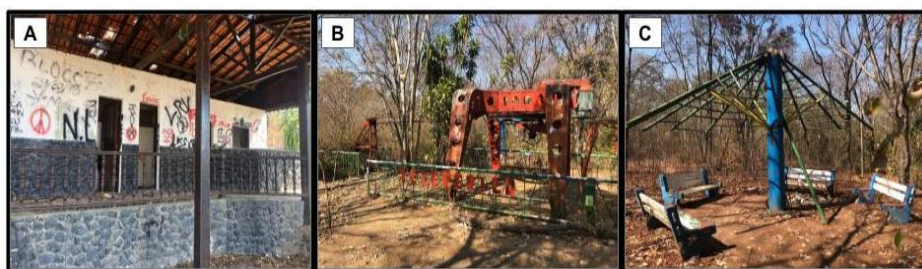
Figura 4 - Estrutura deteriorada do parque. (A) Bar desativado; (B) Teleférico; (C) Espaço de convivência.
