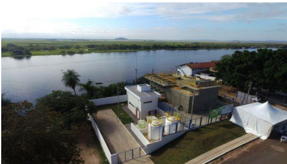
Figura 37 - ETA em Ladário-MS às margens do Rio Paraguai.
