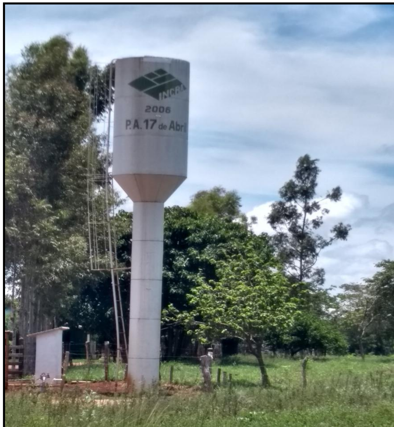
Figura 2 - Reservatórios de água instalado no Assentamento Teijin.
