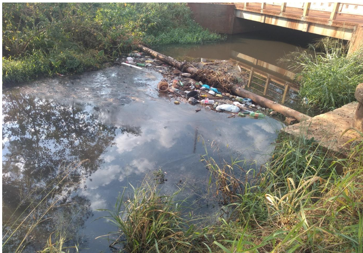
Figura 6 – Depósito de resíduos sólidos no percurso do córrego Rego d’Água no bairro Cachoeirinha. Registros de trabalho de campo realizado no dia 11/02/2019.
